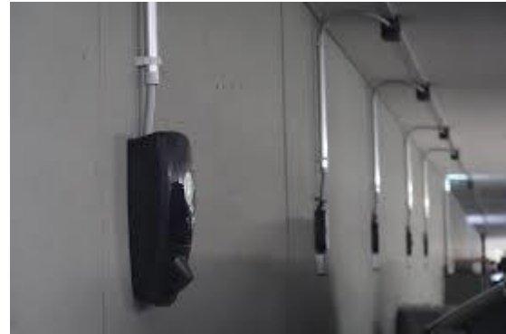
Figura 4 Um carregador instalado numa pré-instalação de multi-carregamento
