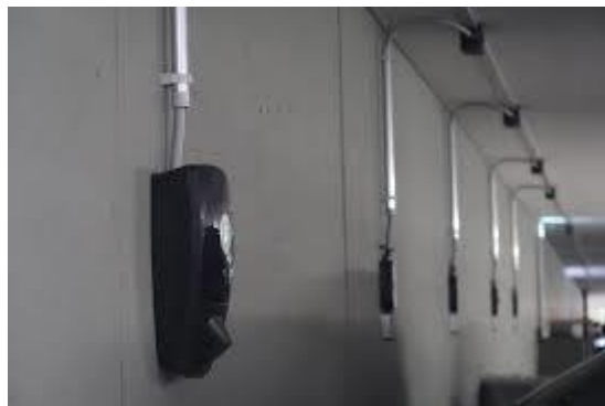
Figura 3 Um carregador instalado numa pré-instalação de multi-carregamento
